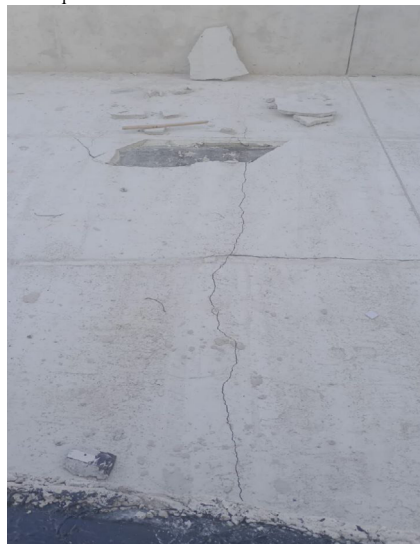
► Figura 5: Fissuras na parte superior da laje da piscina
